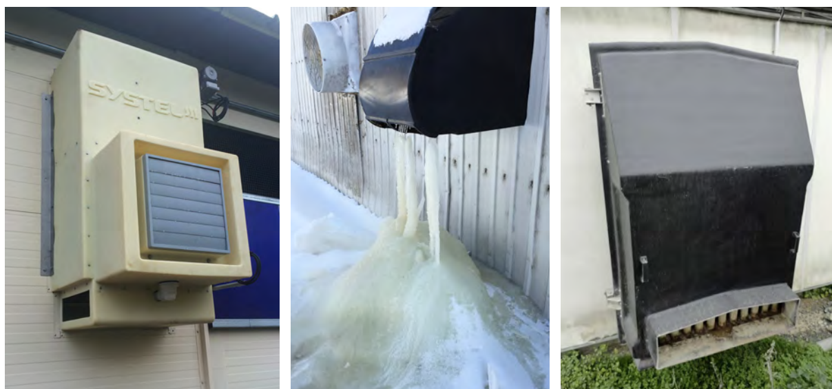
Figure 8 : Les échangeurs récupérateurs de chaleur permettent de limiter l'hygrométrie en ambiance
