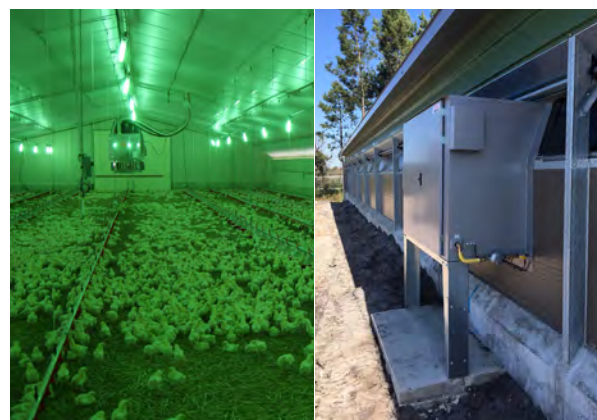
Figure 7 : Les systèmes de chauffage à combustion indirecte limitent la présence de \text{CO}_2 et d'eau en ambiance dans le bâtiment
